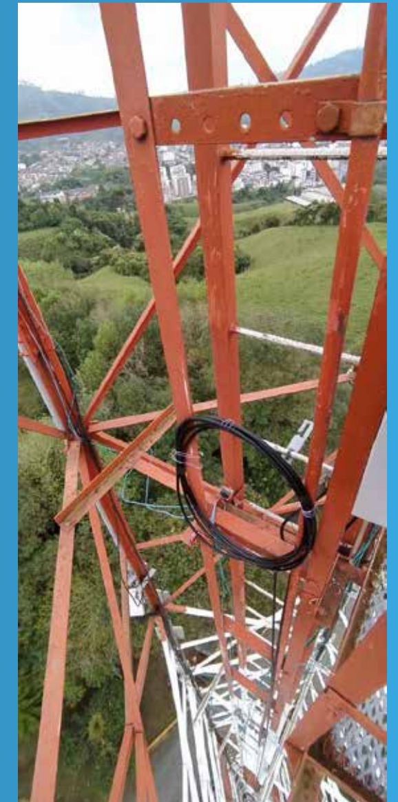
Fibra óptica conexión Radio – enlace principal
